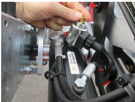
Operación manual de emergencia en todas las electroválvulas
